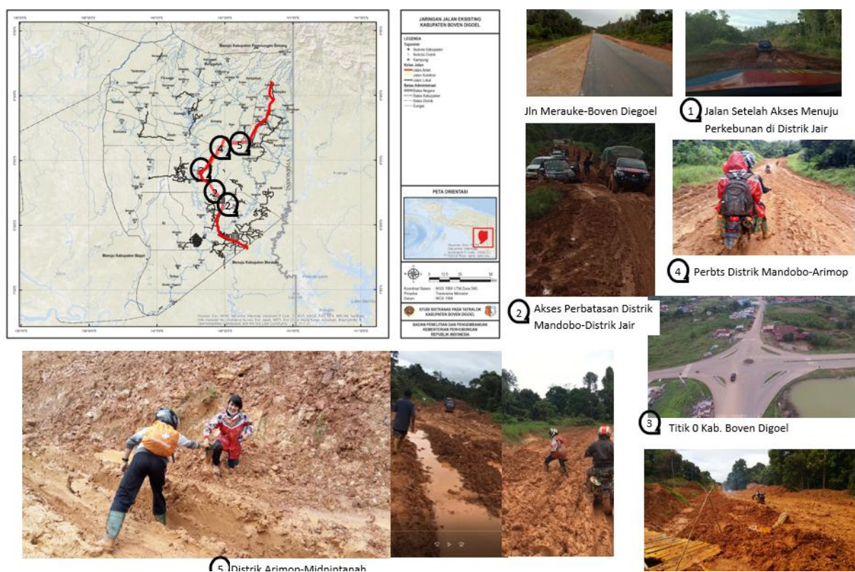
Gambar 4. Kondisi ruas jalan Trans Papua di Kabupaten Boven Digoel.
