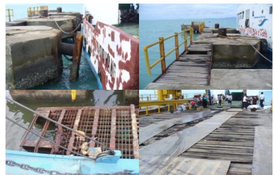
Gambar 1. Kondisi Pelabuhan Penyeberangan Kendari
